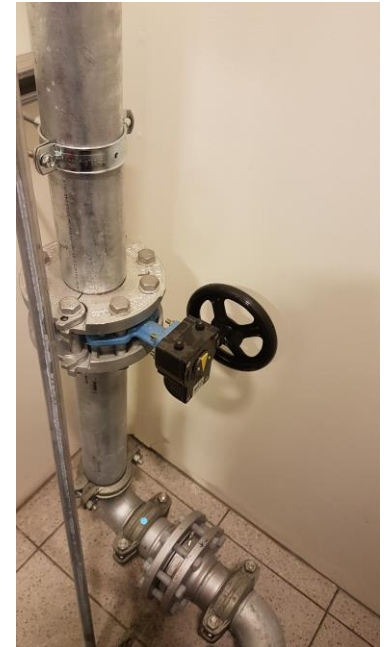
Ventiler uten over- våking, sikring eller skilting
