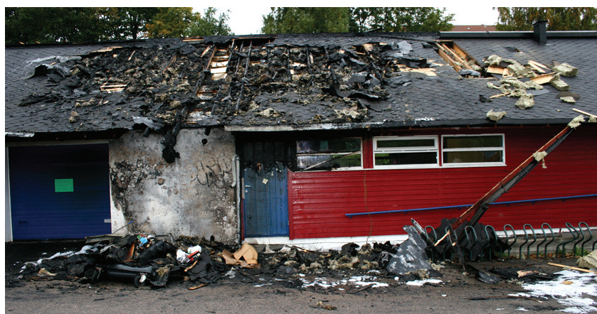
Aktivitetssenter for ungdom i Oslo, brann i avfallsbeholder plassert inntil yttervegg.
